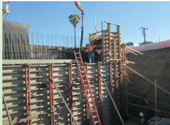
Las cuadrillas colocan formas y se preparan para poner concreto en el puente de la Calle D en Perris.
